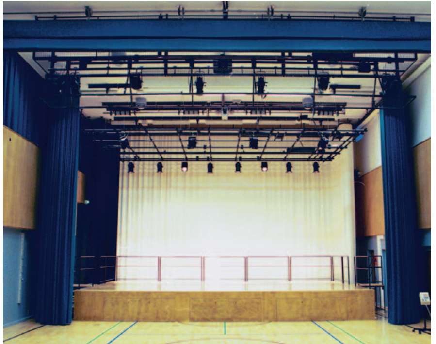
Pedelux-näyttämötekniikkaa: nouseva ja laskeva näyttämö NN 9010, irrotettavat näyttämön suo- jakaiteet, tausta-, sivu- ja esirippuverhot kiskojärjestelmineen, laskevat ja nousevat ansaat valonheittimien ja kulussien kiinnittämiseen. Kaikki toimii sähköisesti, ohjaus siirrettävästä ohjauskeskuksesta. Katsomon tuolit ovat näyttämön alla pyörällisissä tuolivaunuissa. Kottby svenska lägstadium, Helsinki. Pedelux-näyttämöt ovat Teakonin testaamia.
