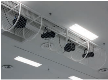
Pallosuojaverkolla varustettu valaisinansas. VMK 250 pallosuojaverkolla PSV 800, ylä-asennossa, Kangasalan lukio.
